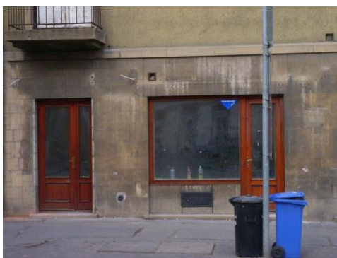
2. ábra: Kőburkolat szennyezetten
